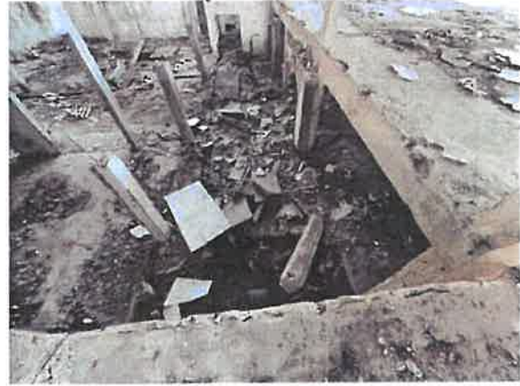
Foto n.º 10 – Resíduos acumulados no interior
