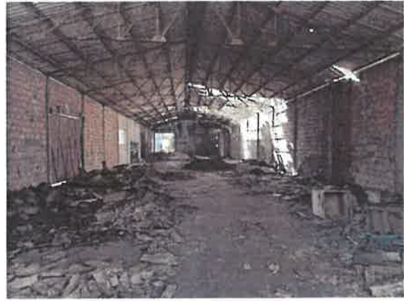
Foto n.º 08 – Resíduos acumulados no interior
