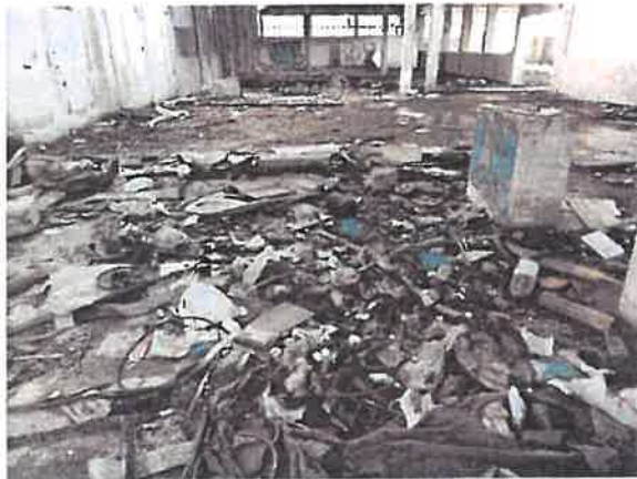
Foto n.º 09 – Resíduos acumulados no interior
